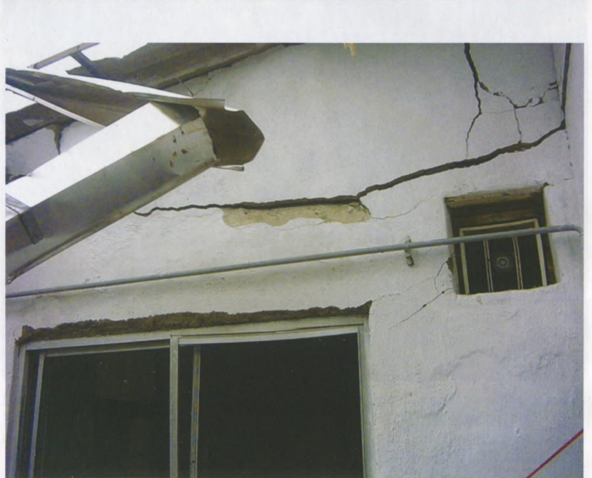
Рис. 6. Повреждения дома в иранском городке Баболь, полученные 2 января 2004 года. Видны также следы высокотемпературного
